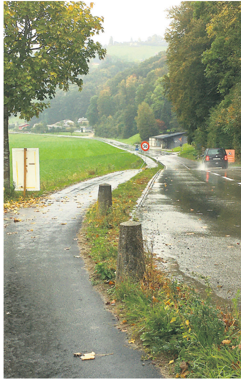
Im Lindental sind die Arbeiten für den Geh- und Radweg in vollem Gang. (Bild: Sandra Ryser)
